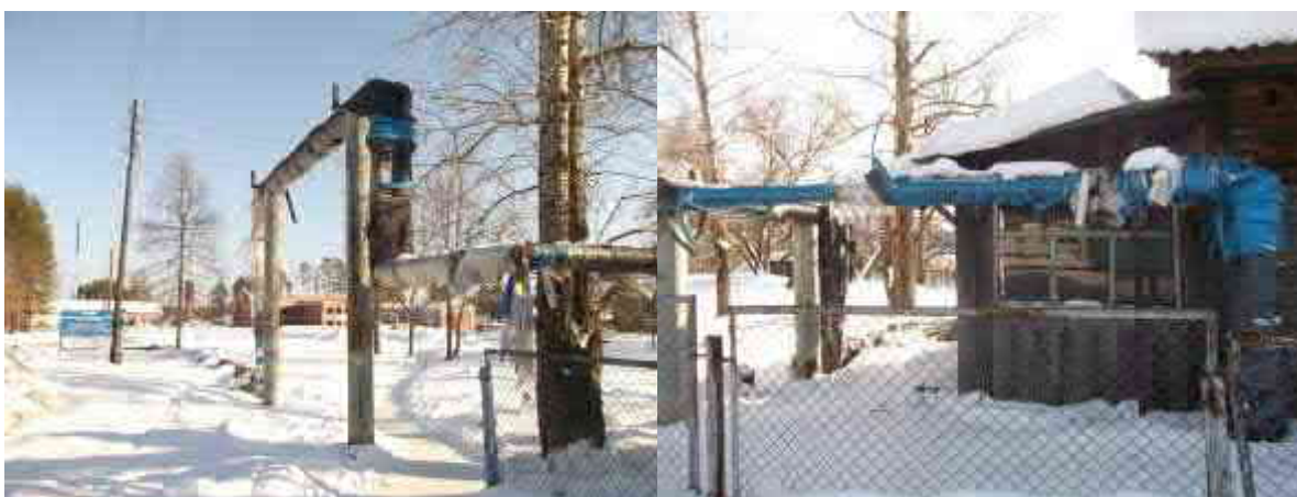
Рис.2.10. Состояние теплосетей от котельной МБОУ «Сельчинская ООШ»
